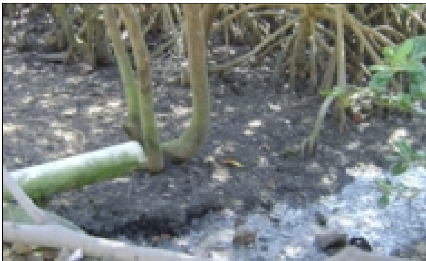
Figura 15 – Esgoto lançado “in natura” no Manguezal do Jequiá - Ilha do Governador, Rio de Janeiro.
